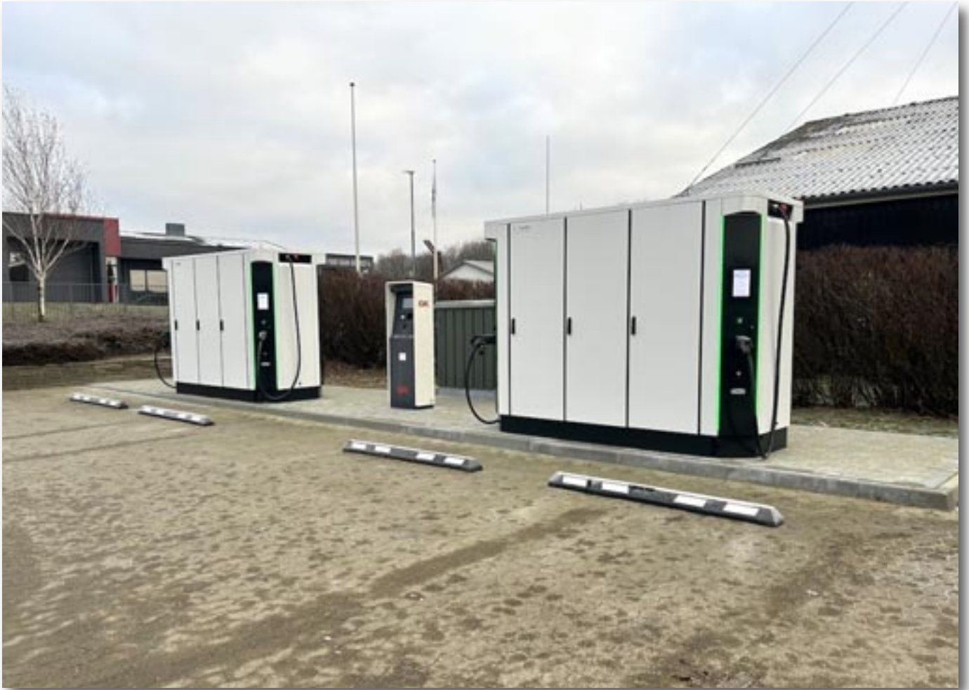
Esbjerg Taxa har fået leveret to batteri-ladestandere.
